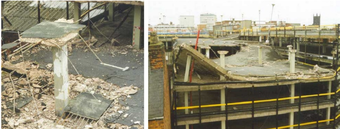
Figura 3.2 – Colapso parcial do edifício Pipers Row Car Park (fonte: Wood (2001))
