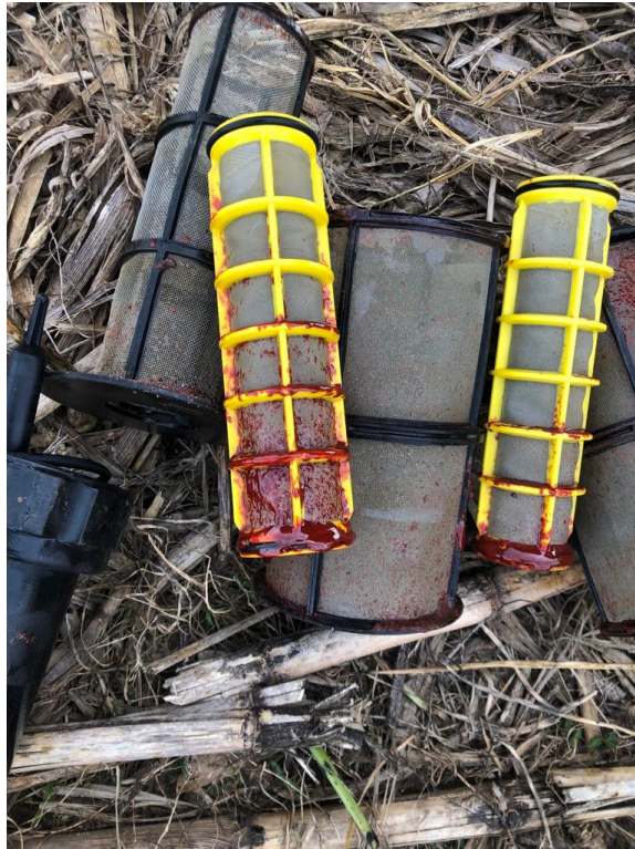
Figura 5 – Residual de produto nos filtros principais e nos filtros de linha
