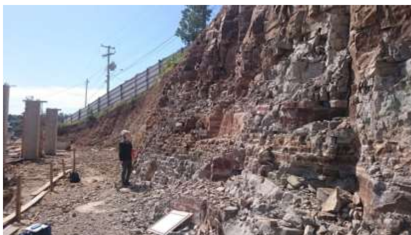
Figura 3 - Vista lateral da face dos Talude 2 (primeiro plano) e Talude 1 (ao fundo). O Talude 2 mostra evidências de tombamento e queda de blocos.
