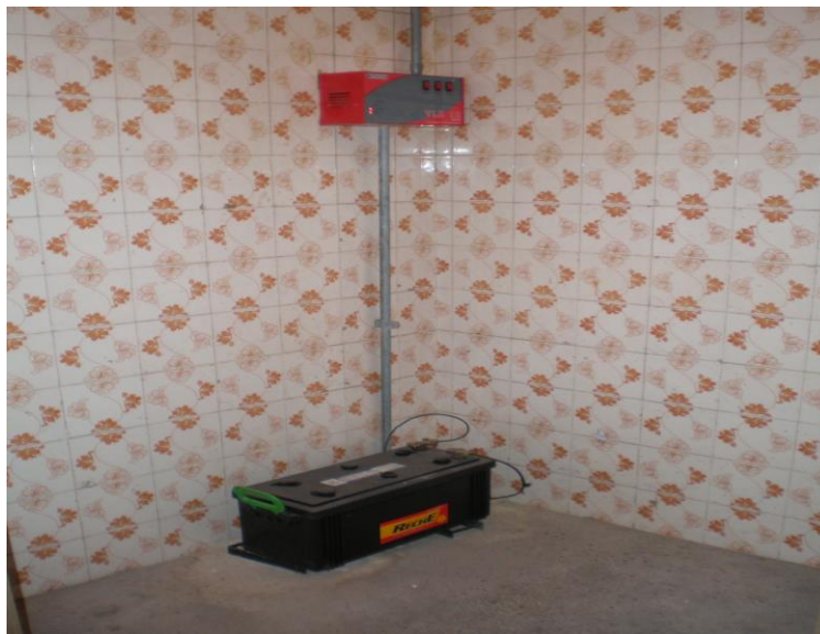
Figura 6 – Bateria das luminárias
