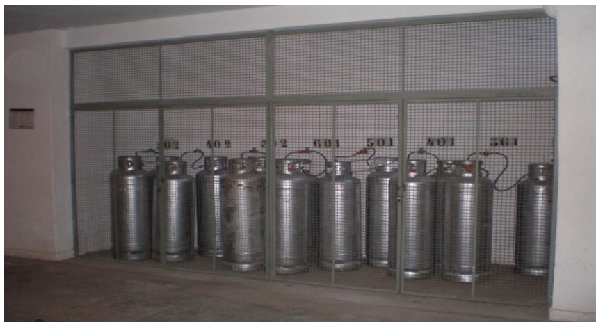
Figura 8 – Central de gás GLP
