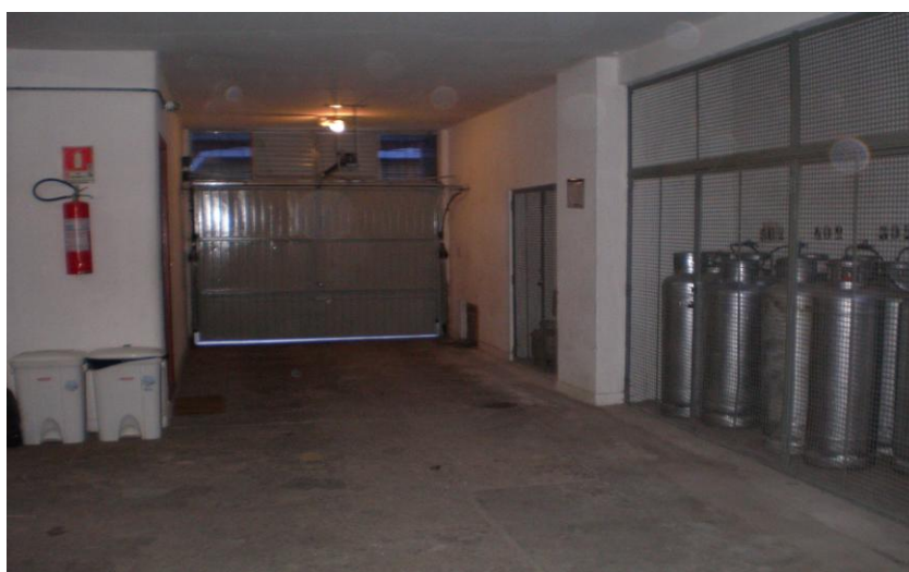
Figura 9 – Central de gás GLP localizada dentro da garagem no térreo
