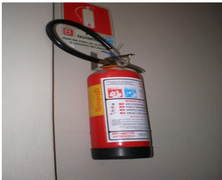
Figura 10 – Extintores de incêndio
