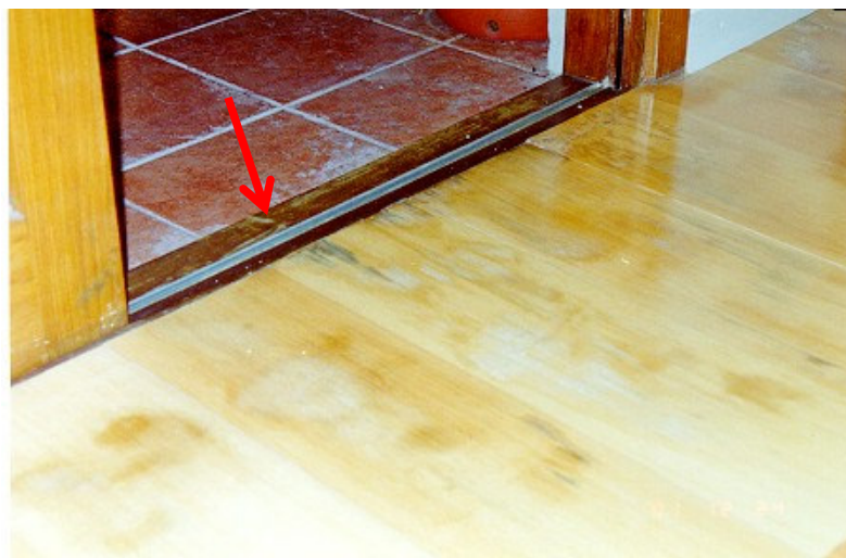
Figura 7 – Manchas em revestimento interno
