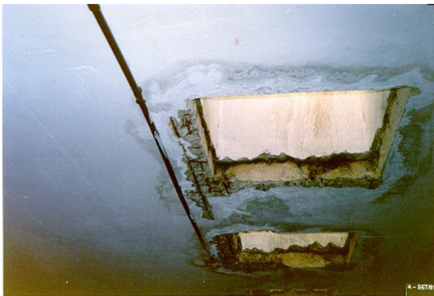
Figura 11 – Domos com infiltração
