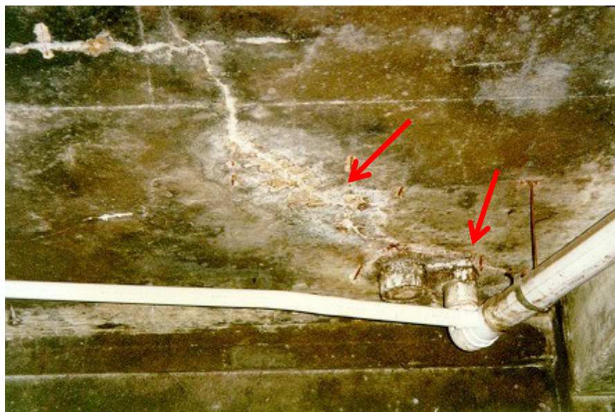
Figura 3 – Fissuras e infiltrações em laje de terraço
