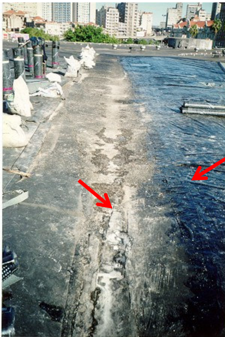
Figura 1 – Problema de transpasse em manta asfáltica
