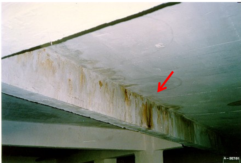
Figura 2 – Infiltração junto à viga de concreto
