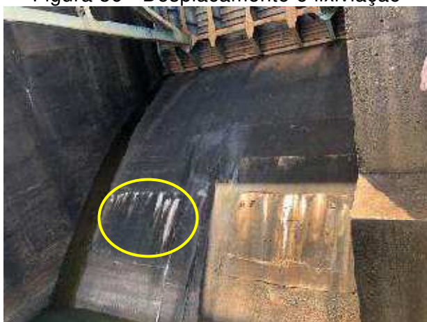
Figura 36 - Desplacimento e lixiviação
