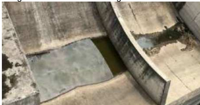
Figura 46 - Acúmulo de água no vertedouro
