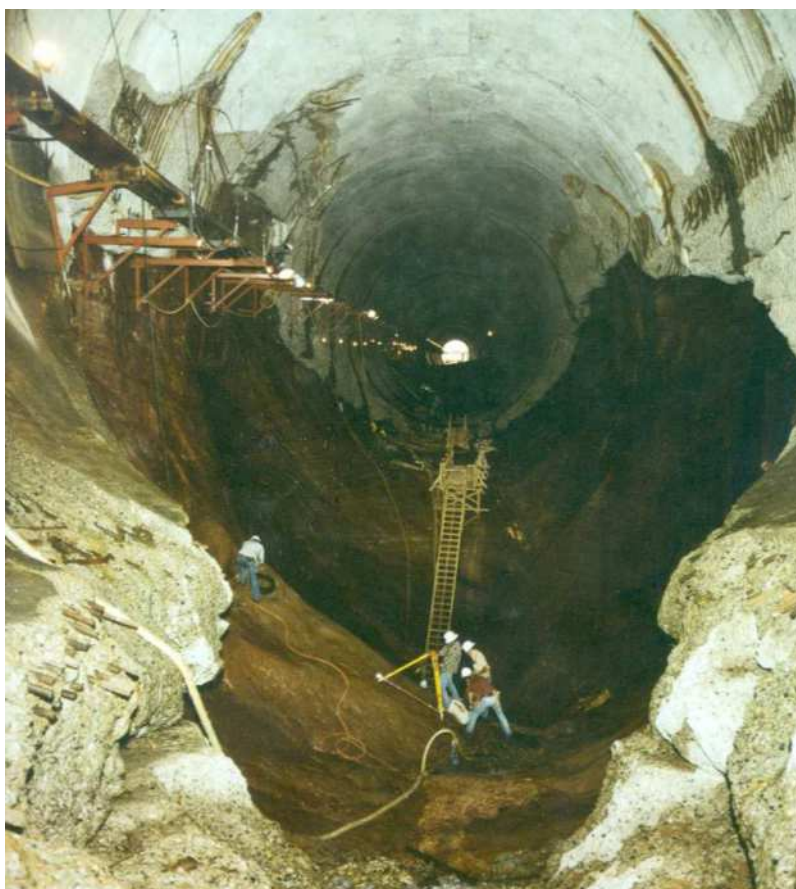
Figura 9 – Dano por cavitação na barragem Glen Canyon
