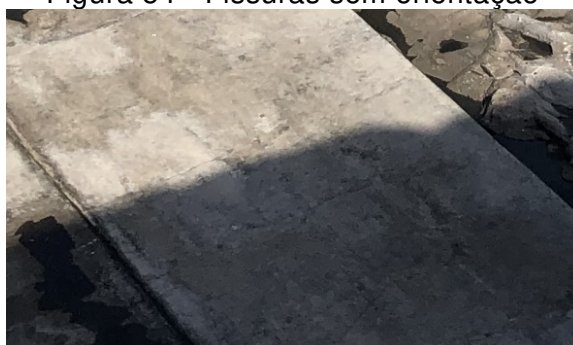
Figura 54 - Fissuras sem orientação
