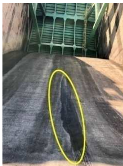
Figura 26 – Surgências com lixiviação de hidróxido de cálcio: vão 13
