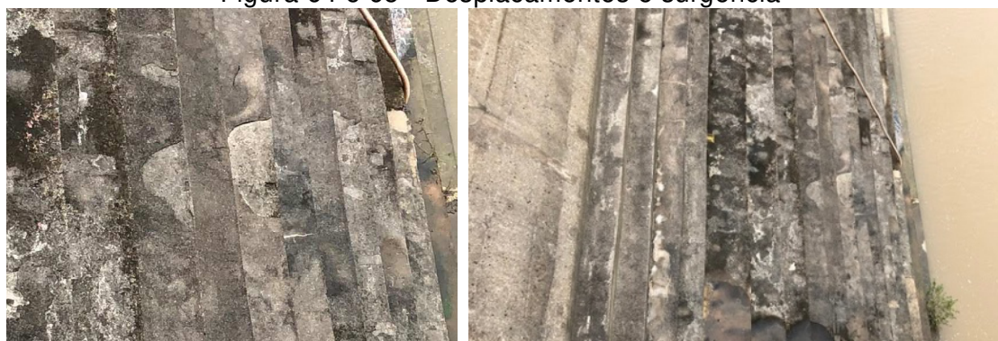
Figura 64 e 65 - Deslocamentos e surgência
