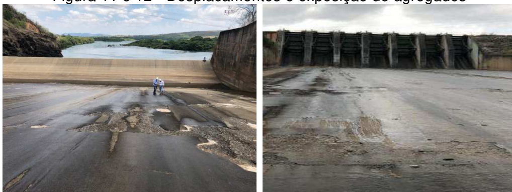
Figura 11 e 12 - Deslocamentos e exposição de agregados
