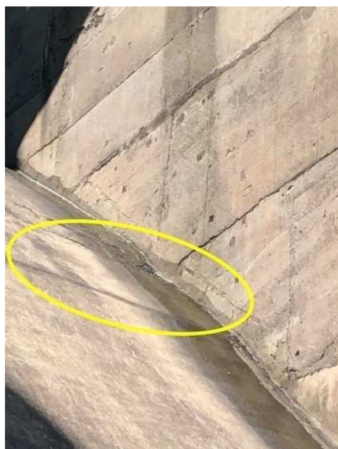
Figura 34 – Descontinuidade na superfície do concreto: vão 13
