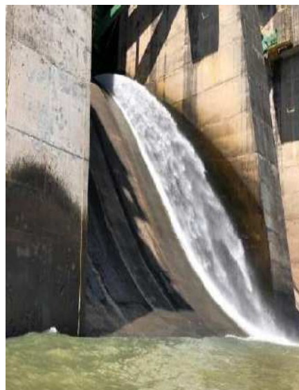
Figura 28 – Vazamento em função da falta de vedação das comportas: vão 5
