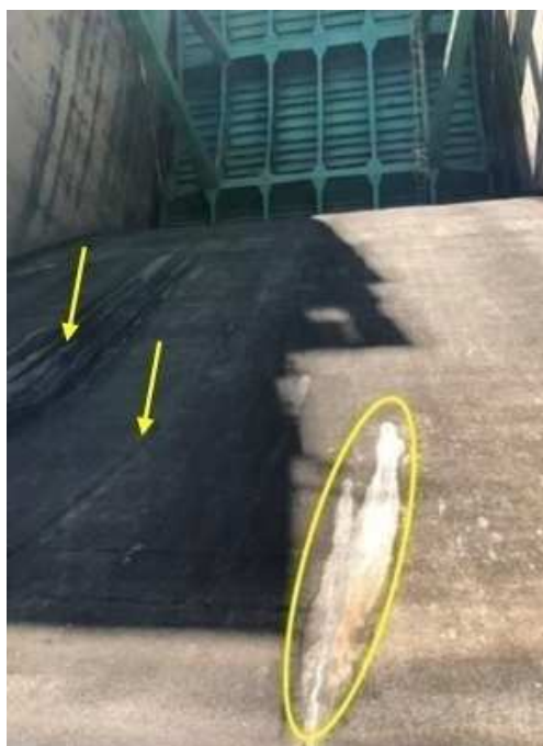
Figura 30 – Presença de hidróxido de cálcio lixiviado e fissuras: vão 6
