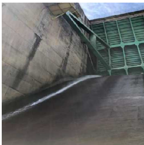
Figura 27 – Vazamento em função da falta de vedação das comportas: vão 2
