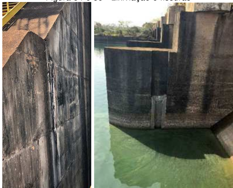
Figura 34 e 35 - Lixiviação e fissuras
