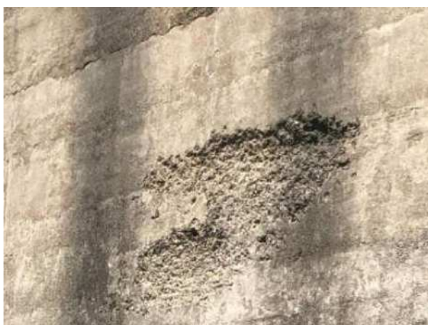
Figura 29 – Fissuras com orientação e exposição de agregados: vão 15
