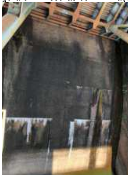
Figura 31 - Fissuras com lixiviação
