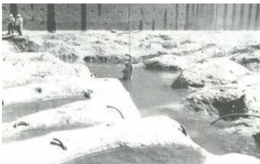
Figura 8 – Usina hidrelétrica Dworshak após abrasão hidráulica
