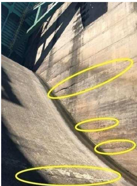
Figura 23 – Descontinuidade das juntas de concretagem no muro lateral e fissuras na calha do vertedouro
