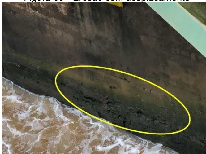
Figura 60 - Erosão com deslocamento
