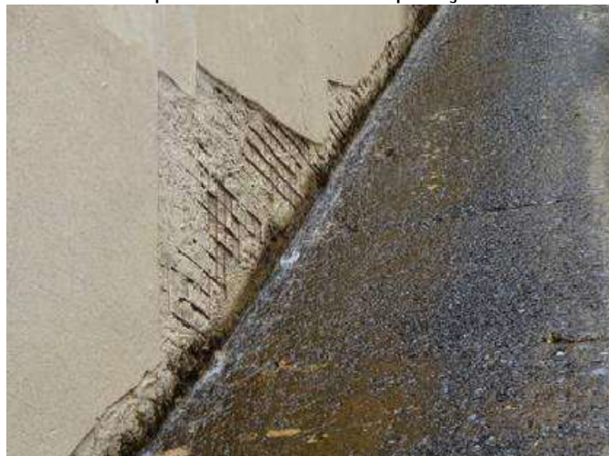
Figura 10 - Deslocamento com exposição de armadura
