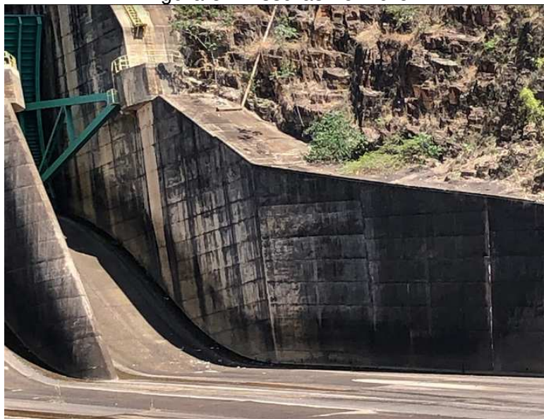
Figura 3 - Fissuras no muro
