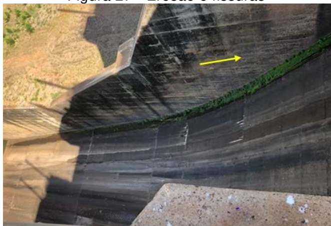
Figura 27 - Erosão e fissuras
