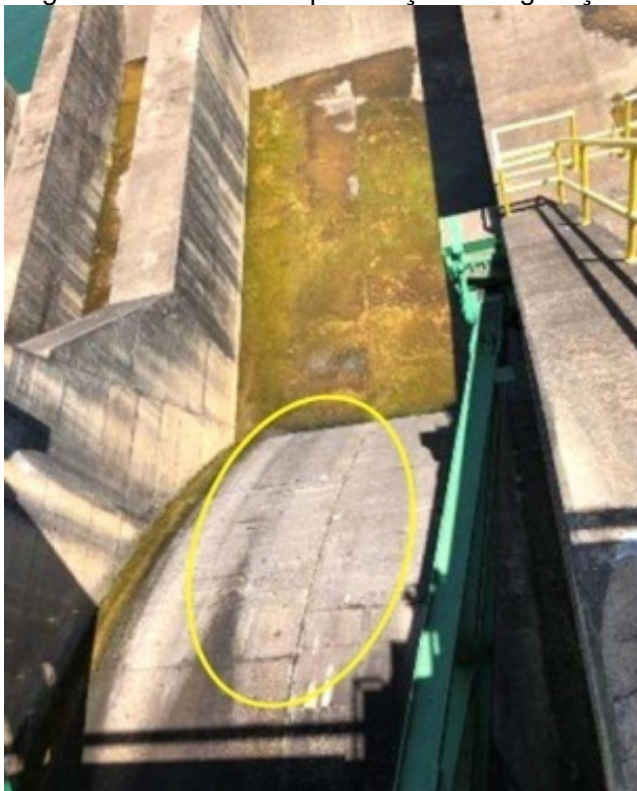
Figura 21 - Fissura e presença de vegetação
