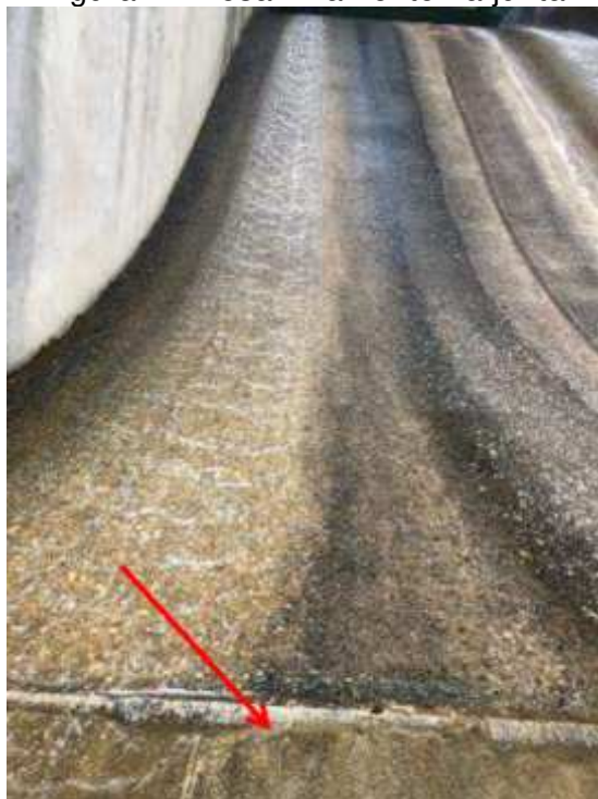
Figura 7 - Desalinhamento na junta
