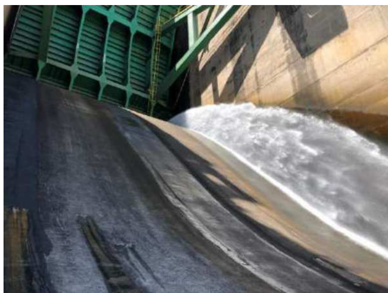
Figura 17 – Vazamento na comporta do Vão 5
