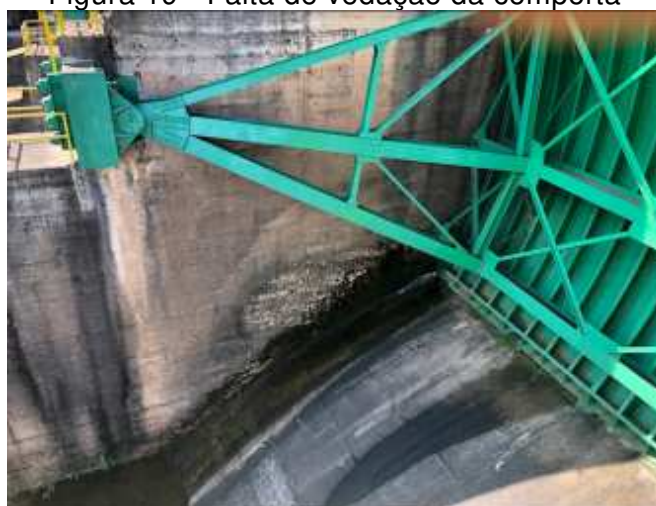
Figura 19 - Falta de vedação da comporta
