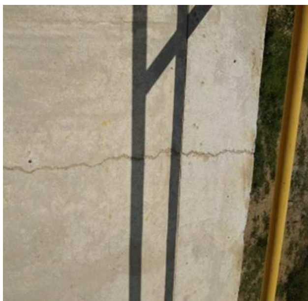
Figura 5 – Fissura transversal em barragem
