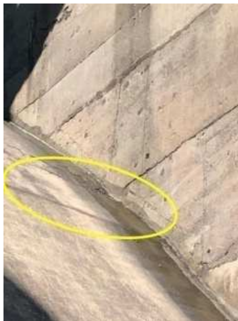
Figura 24 - Desalinhamento da superfície do vertedouro na região de encontro entre calha e muro
