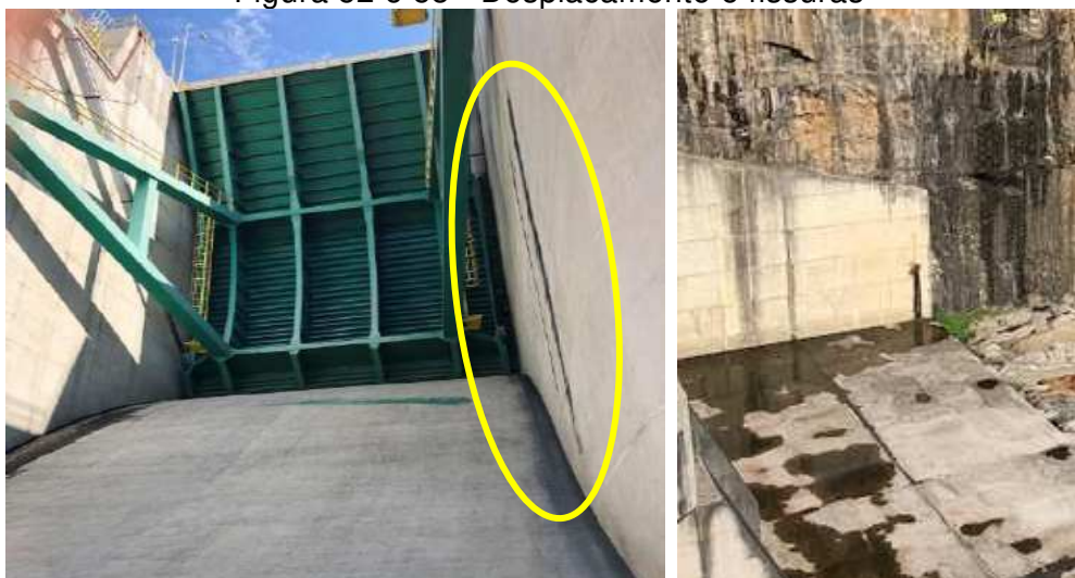
Figura 52 e 53 - Deslocamento e fissuras
