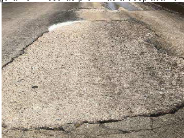
Figura 13 - Fissuras próximas a deslocamentos
