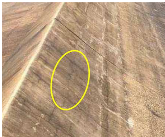
Figura 1 - Fissuras e descontinuidades
