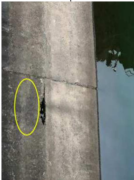
Figura 32 - Detalhe de erosão e deslocamento nas juntas transversais
