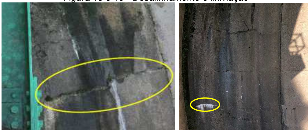
Figura 15 e 16 - Desalinhamento e lixiviação
