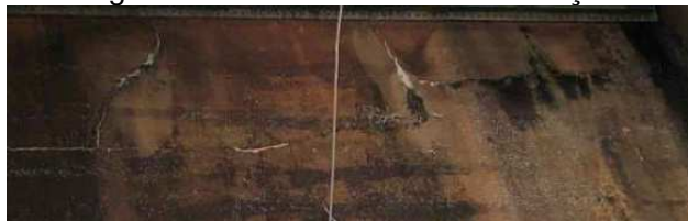
Figura 43 - Fissuras com orientação
