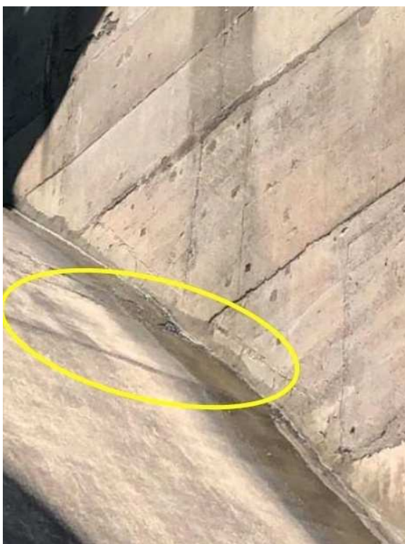
Figura 18 – Descontinuidade de superfície do vertedouro no vão 13
