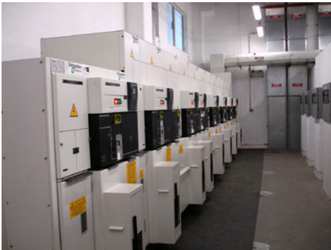
Imagem 18 – Centro medição em média tensão – Fonte: Arquivo Shopping
