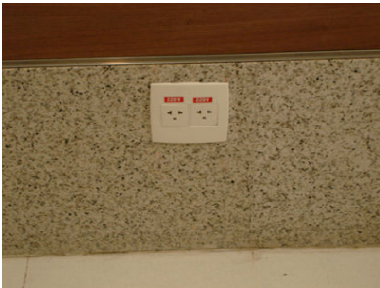
Imagem 5 – Tomada parede mall – Fonte: Arquivo Shopping
