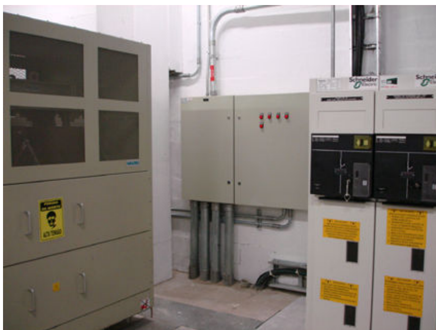
Imagem 14 – Subestação – Fonte: Arquivo Shopping
