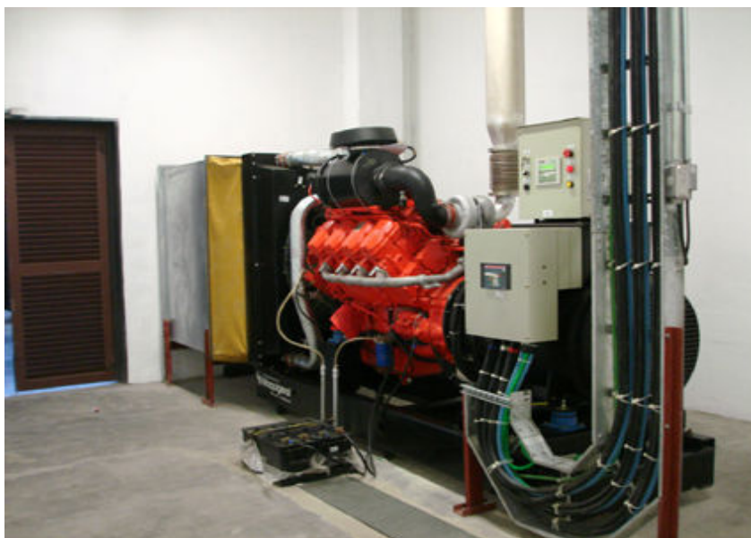
Imagem 17 – Gerador – Fonte: Arquivo Shopping
