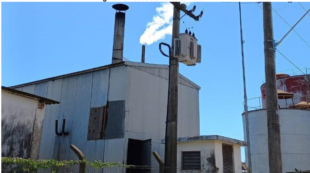
Figura 13 - Subsistema de caldeira.
