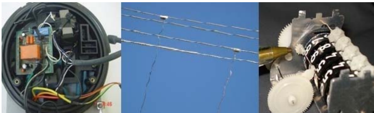
Figura 27: Outras irregularidades – à esquerda, inclusão de circuito eletrônico para a manipulação remota do funcionamento do medidor; ao centro, ligação direta da rede de distribuição; à direita, adulteração das engrenagens do medidor
