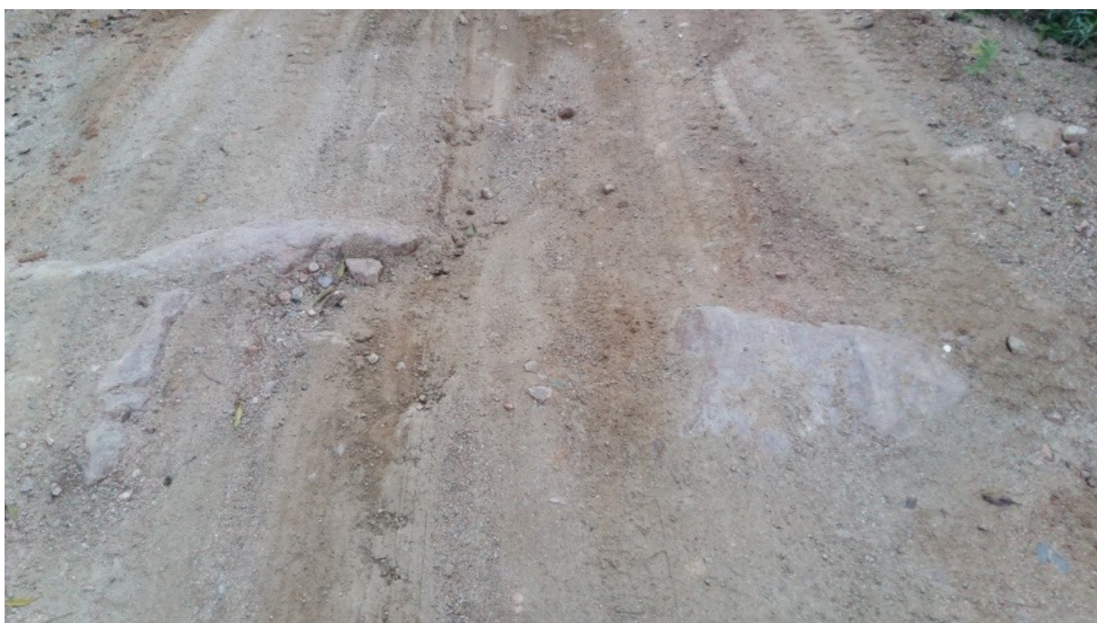
Figura 13 - Trecho com afloramento de rocha na estrada que leva à praia da Pedreira, Parque Estadual de Itapuã, Viamão, 03/07/17.
