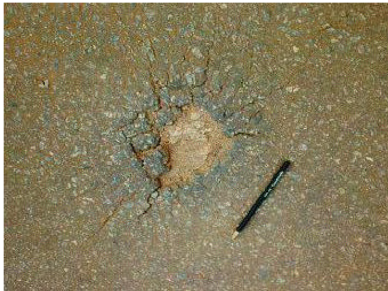
FIGURA 8 Características expansivas de um pavimento rodoviário construído com escória LD – Ouro Branco/MG
