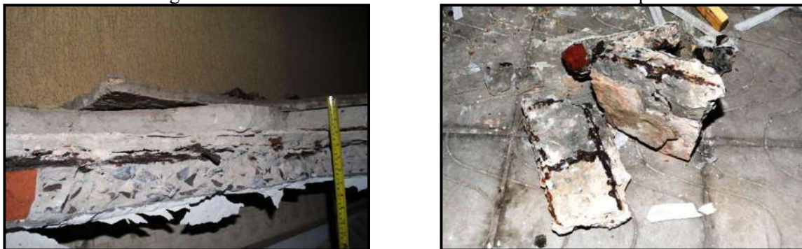
Figura 2 - Detalhe da armadura do elemento estrutural colapsado
