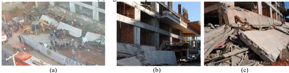
Figura 9 - (a) Vista geral de marquise desabada durante construção de prédio, (b) tipologia do elemento e (c) segunda marquise existente
