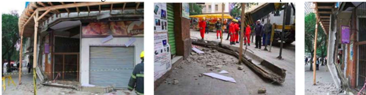
Figura 6 - Vistas da estrutura desabada sobre a via pública
