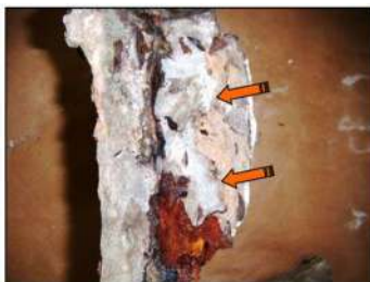
Figura 4 - Presença de cloretos na massa de concreto (indicadas pelas setas)
