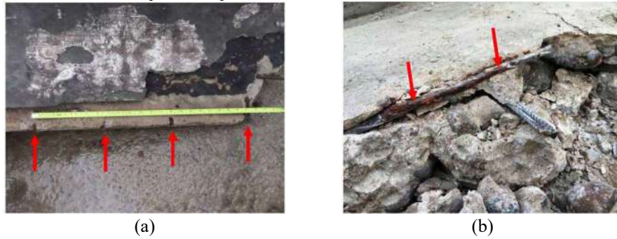
Figura 8 – (a) Posições da ferragem de ancoragem no elemento colapsado (setas) e (b) barra de aço da Marquise B apresentando corrosão localizada
