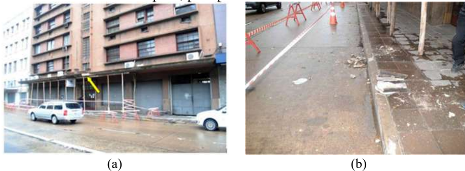
Figura 11 - (a) Marquise desabada durante construção de prédio e (b) material de revestimento da marquise, precipitado sobre a via
