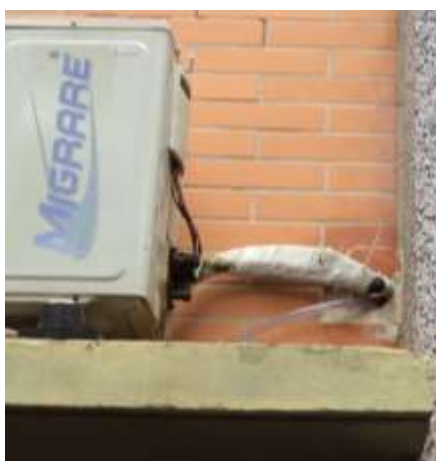
Figura 10:49 Locais de instalação dos ar condicionados na fachada nordeste – detalhes e danos associados
