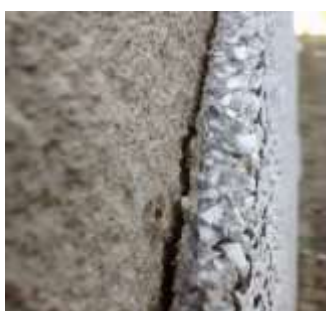
Figura 5:45 Descolamento na interface emboço/revestimento
