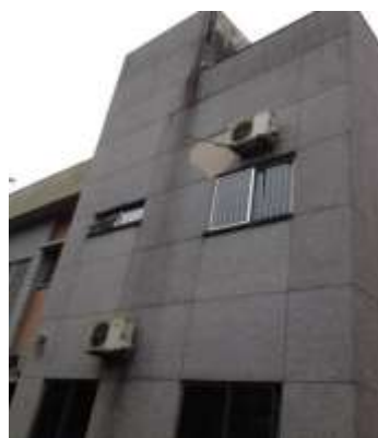
Figura 9:47 Locais de instalação dos ar condicionados na fachada sudoeste – detalhes e danos associados
