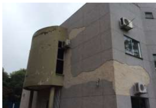
Figura 11:48 Locais de instalação dos ar condicionados na fachada sudeste – detalhes e danos associados
