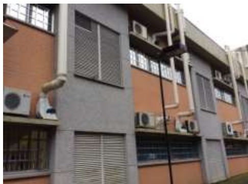
Figura 8: Locais de instalação dos ar condicionados na fachada sudoeste – detalhes e danos associados
