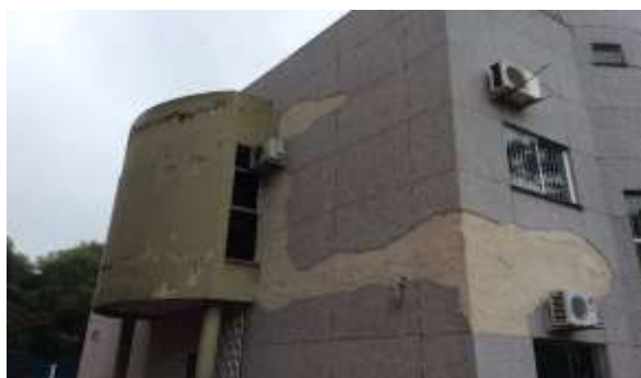
Figura 4:44 Deslocamento do Revestimento de Fulget
