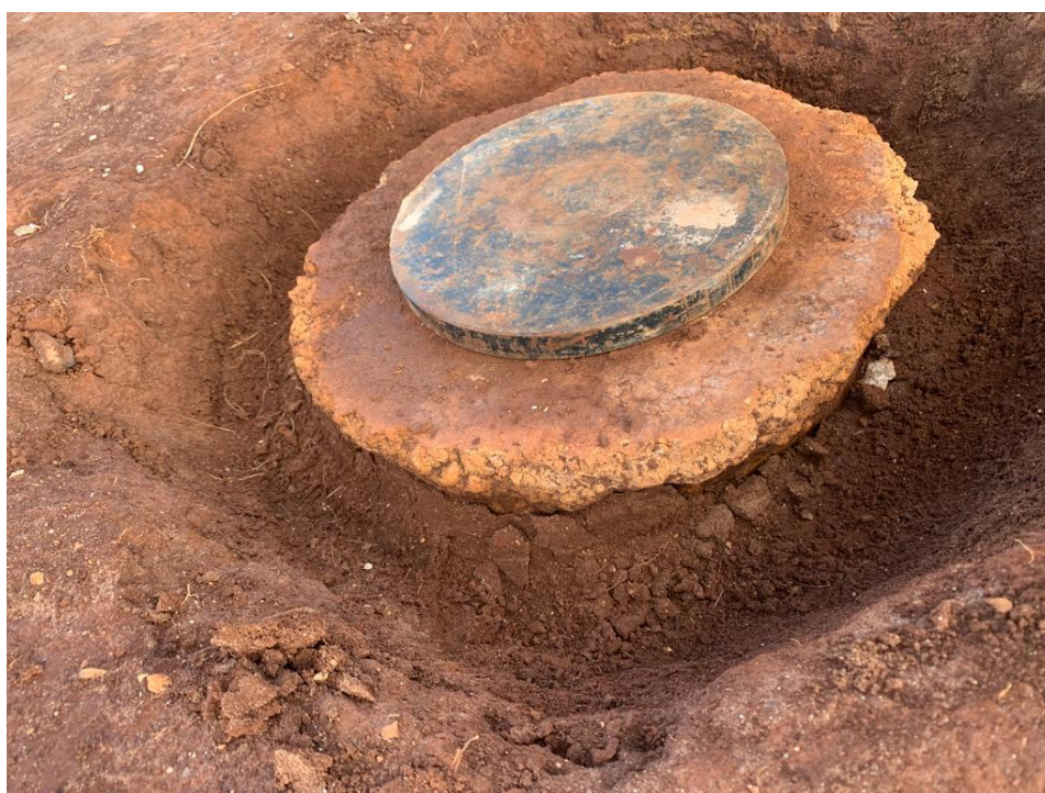
Figura 4.11 - Afundamento da camada no solo.
