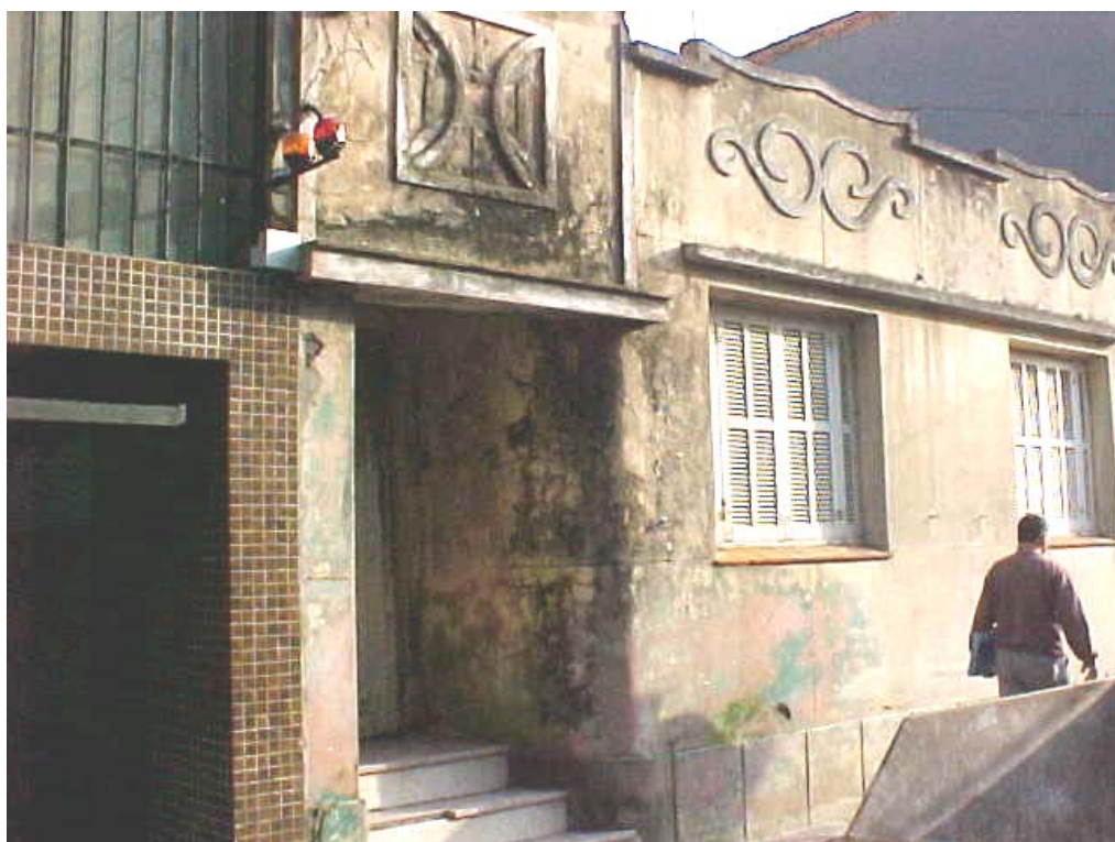
FIGURA D.9 – Umidade acidental, manchas de sujeira e vegetação parasitária.
