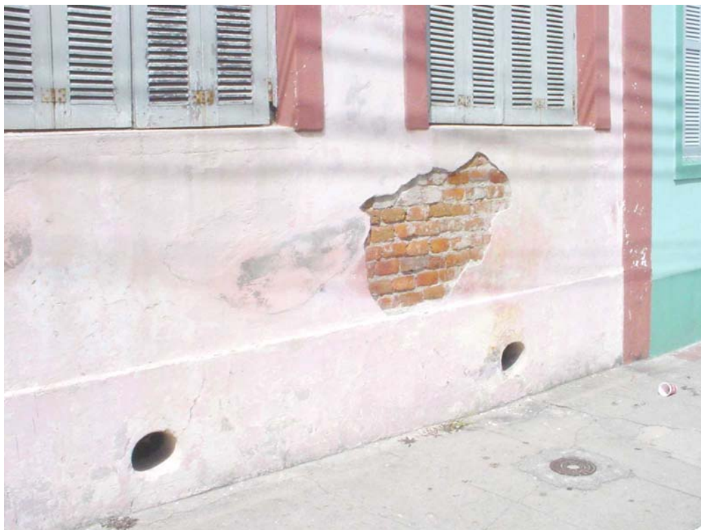
FIGURA D.1 – Descolamento do revestimento de argamassa inorgânica.
