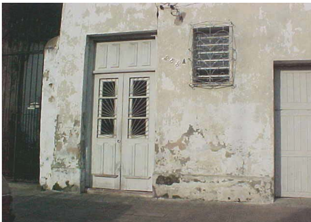
FIGURA D.10 – Umidade ascensional, vegetação parasitária e descolamento e descoloração da pintura.
