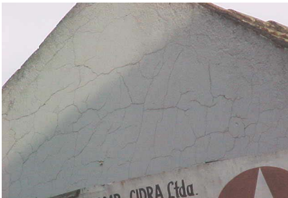
FIGURA D.5 – Fissuras do tipo mapeamento.
