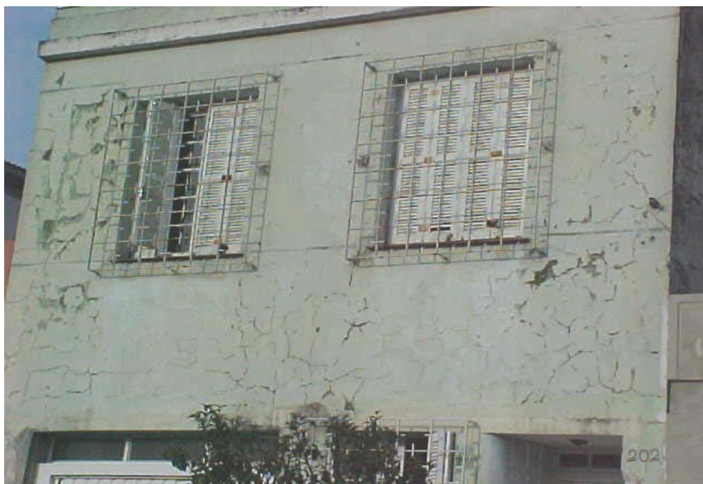
FIGURA D.6 – Fissuras do tipo mapeamento, manchas e descolamento da pintura.
