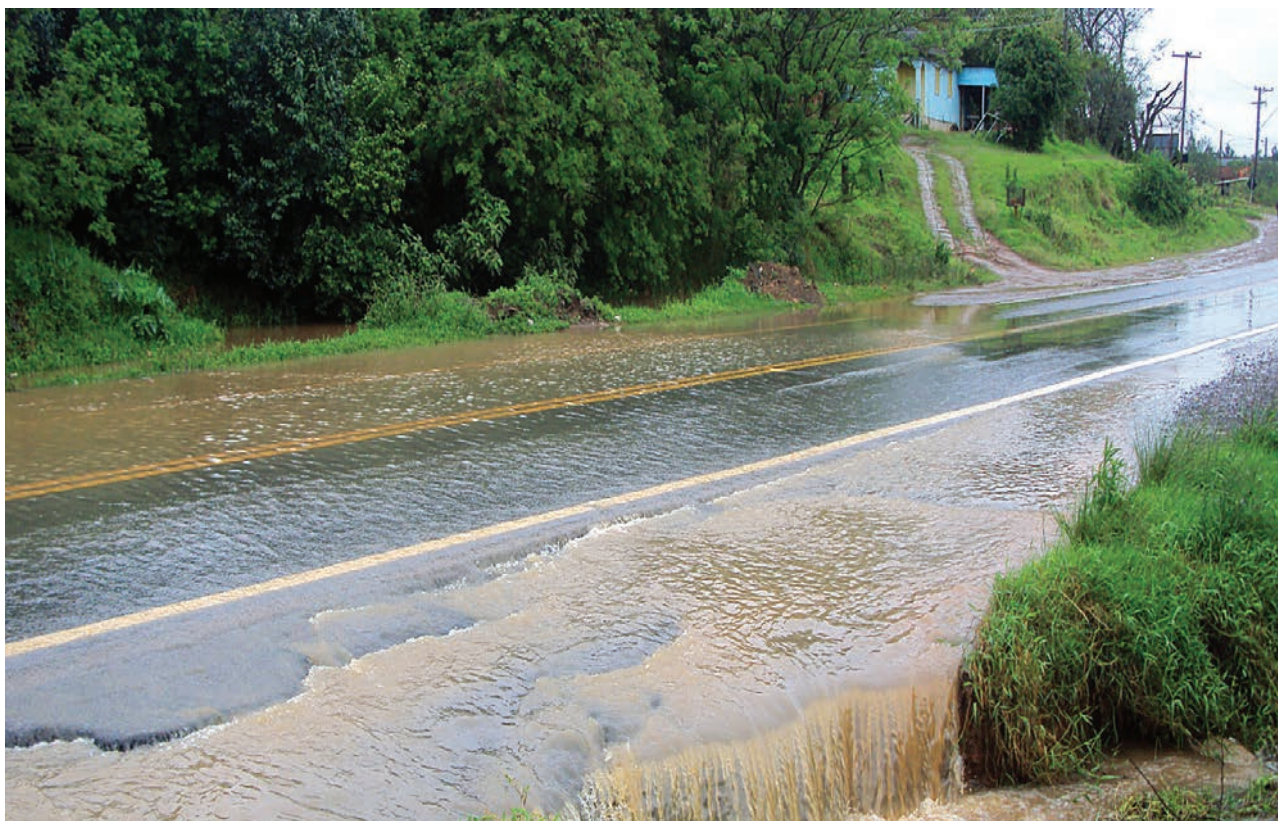
Figura 04: Local com falta de rede de drenagem pluvial na RS-030
