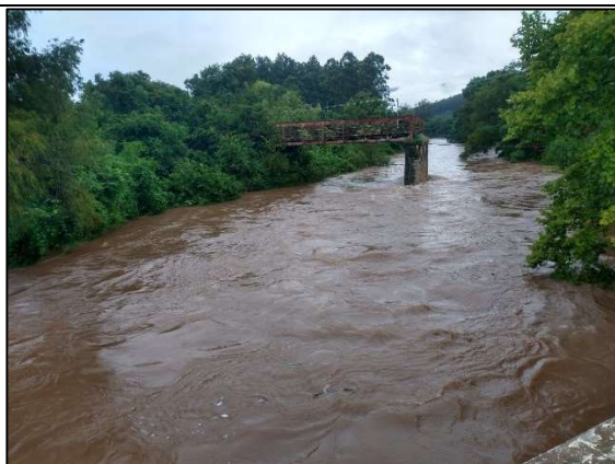
Figura 69. Inundação Março/2023 – ERS-239/Ponte sobre o Rio Rolante.
