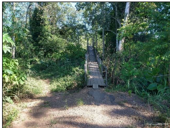
Figura 62. Foto sem inundação – Rua Oscar Alcindo Ritter/ponte pênsil.
