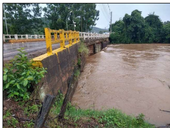
Figura 87. Inundação Março/2023 – Ponte Júlio Schneider.
