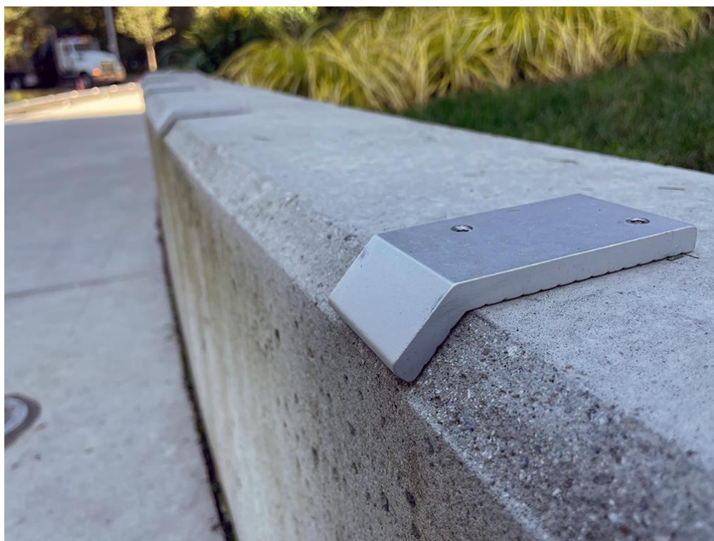
Figura 4: Skate stoppers, para impedir o uso da cantoneira como equipamento urbano para manobrar.
