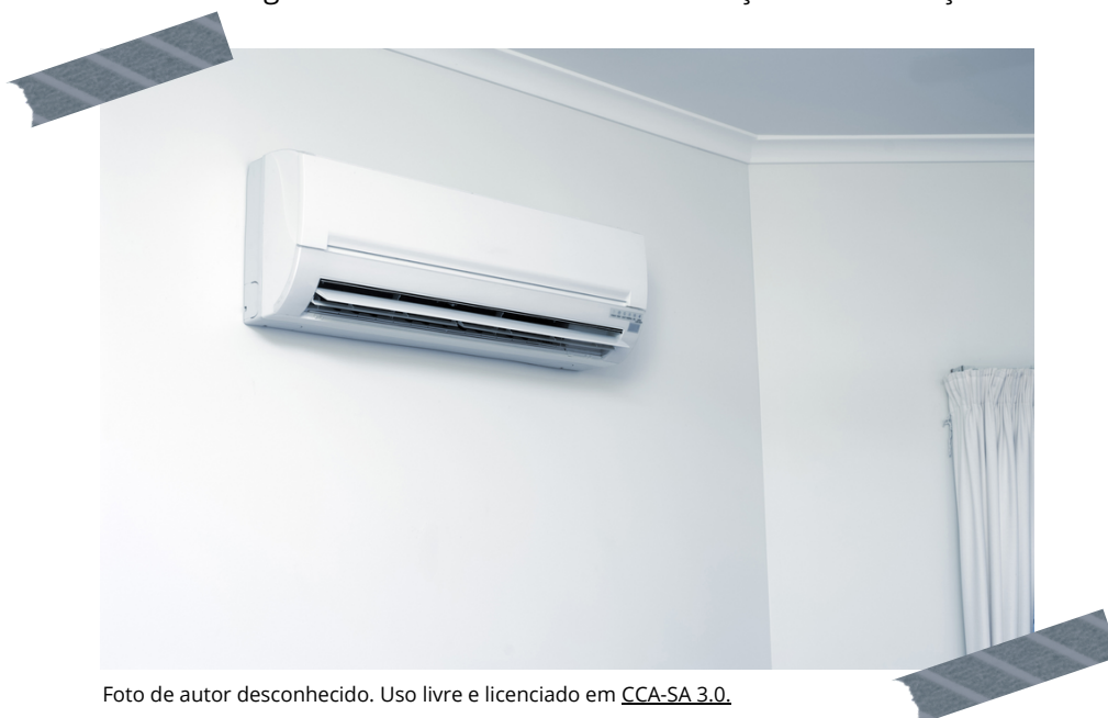
Figura 17 - Ar condicionado em Serviço de Alimentação
