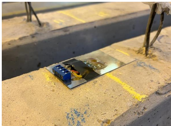
Figura 44 – Desnível entre a superfície de concreto e a placa
