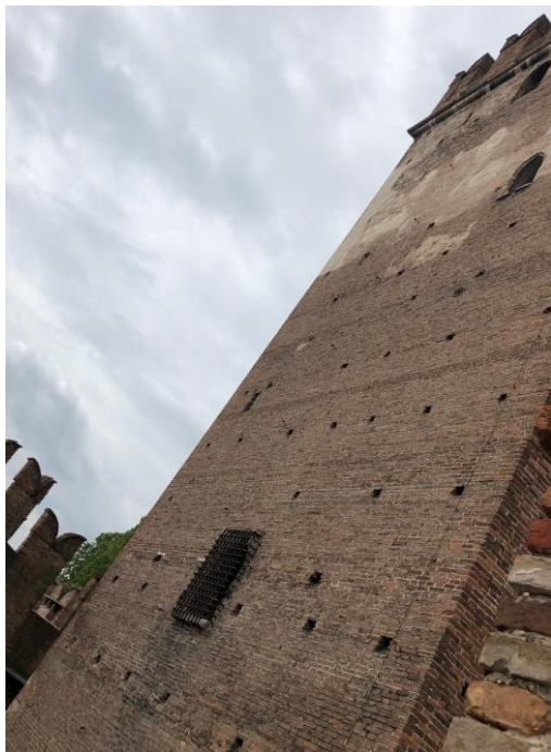
Figura 47 – Detalhes da Torre del Martio, tijolos e rusticação Fonte: Fotos tiradas em abril de 2019 em visita realizada pela autora.
