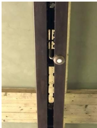
Figura 212 – Detalhe da luminária Fonte: Foto pela autora em visita abril 2022.
