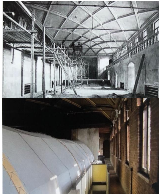
Figura 255 – Imagem da restauração de Avena e imagem atual, que encontra-se parcialmente revestida, e seu forro escondido. Apenas o setor administrativo tem acesso
