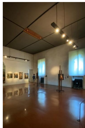
Figura 216 – Forro metálico com trilhos suspensos Fonte: Foto pela autora em visita abril 2022.
