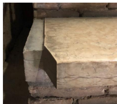
Figura 118 - Detalhe do recorte da pedra chegando no concreto da escada Fonte: Foto da autora, visita em abril de 2022.
