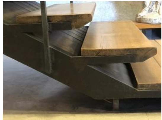
Figura 81 – Detalhe estrutural da escada, com degrau em madeira Fonte: Foto da autora, visita em abril de 2022.
