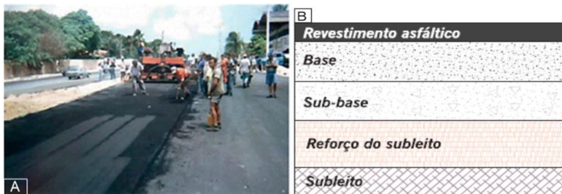
Figura 8 - (A) Pavimentação asfáltica sendo executada. (B) Estratificação da pavimentação asfáltica. Retirado de Bernucci et al., 2008.
