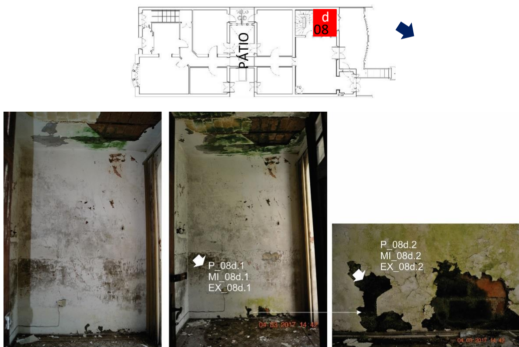
Figura 29 – Manifestação patológica observada e identificada na superfície do Ambiente 08
