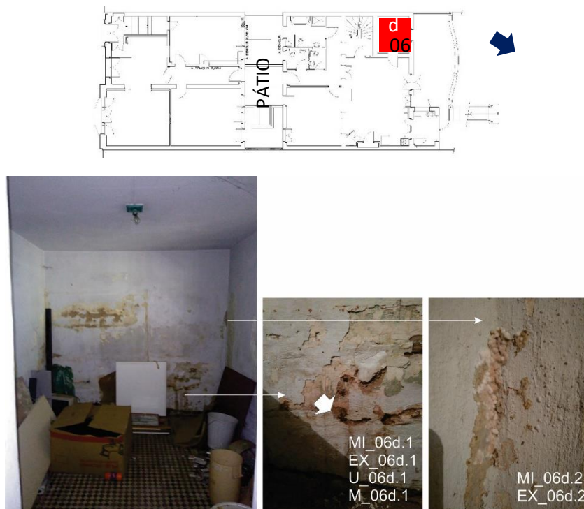
Figura 28 – Manifestação patológica observada e identificada na superfície do Ambiente 06
