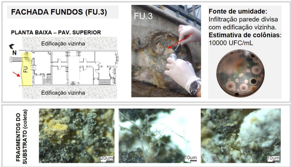
Figura 59 – Coleta biológica na Fachada dos fundos, amostra FU.3
