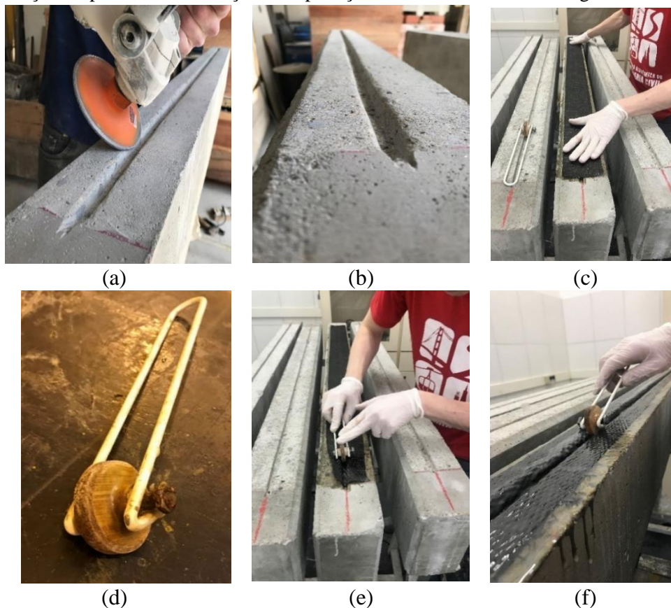
Figura 56 - Detalhes construtivos do método de incremento de ancoragem EBRIG: (a) e (b) remoção e arredondamento das arestas externas da ranhura; (c) posicionamento do reforço à flexão; (d) e (e) dispositivo de aplicação do reforço contornando a seção transversal da ranhura; (e) laminação e finalização do processo de reforço com aplicação de incremento de ancoragem EBRIG
