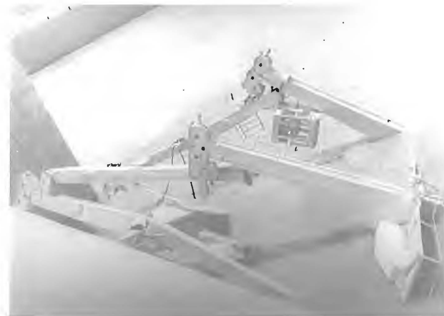
Figura 25b – Pórtico de manobras na barragem de Bom Retiro do Sul, RS.
