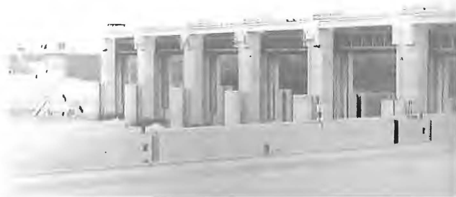
Figura 25a – Pórtico de manobras na barragem de Bom Retiro do Sul, RS.
