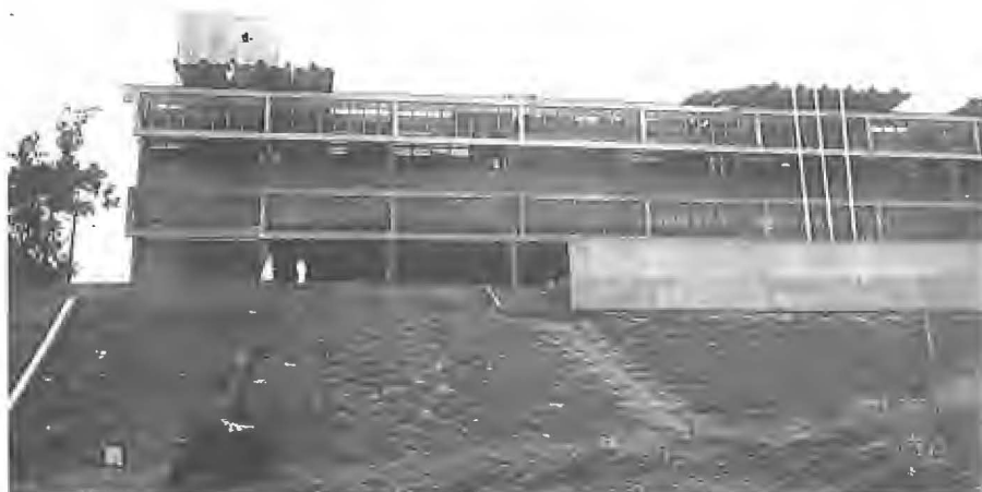
Figura 15 – Arrancamento de telhas de fibrocimento de grande porte.
