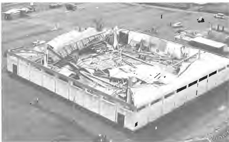
Figura 17e – Destruição total de telhado em Lageado, RS.
