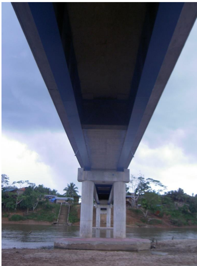
Figura 5-20 – Laje inferior na região dos apoios internos - Fonte: VSM Engenharia.
