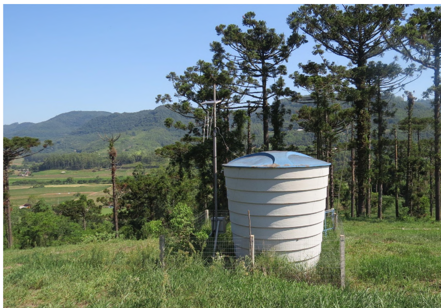
Figura 22 – Reservatório Linha São João.
