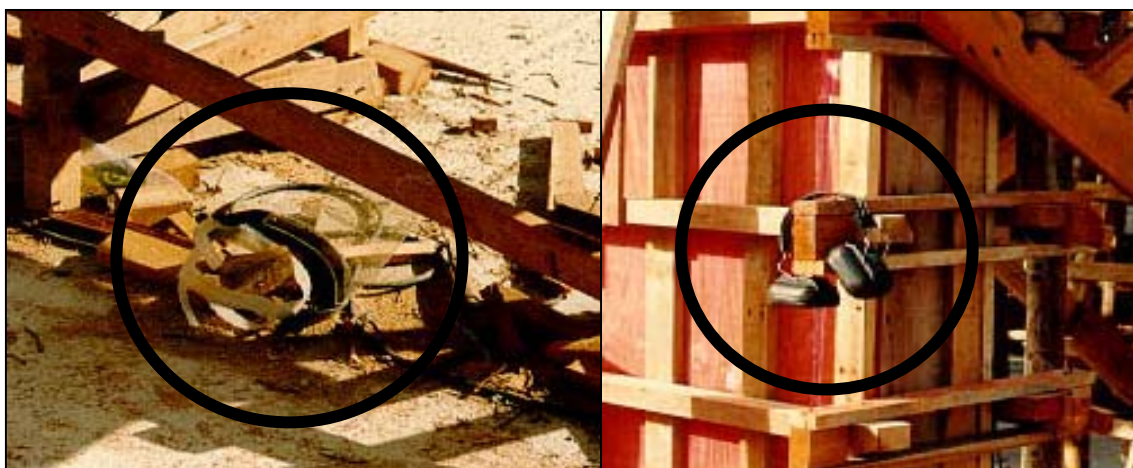
Figura 5.13 – Dois exemplos da falta de preocupação em relação à utilização dos EPI.
