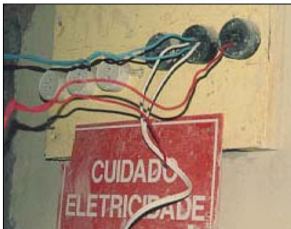
Figura 5.14 – Exemplo de improvisação das instalações elétricas.
