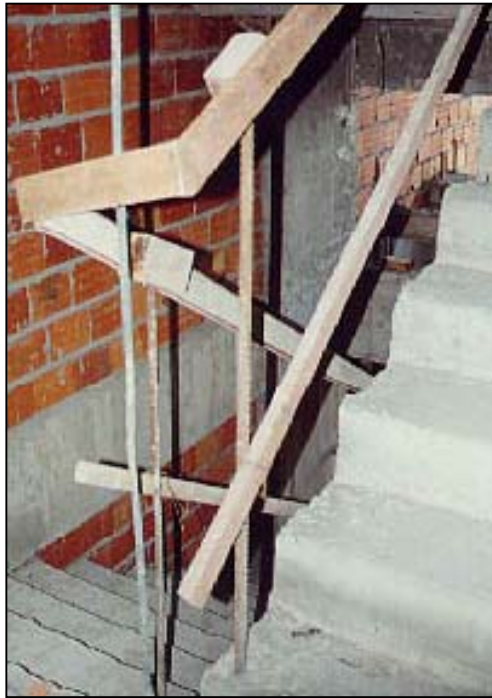
Figura 5.8 – Exemplo de corrimão de uma escada permanente.
