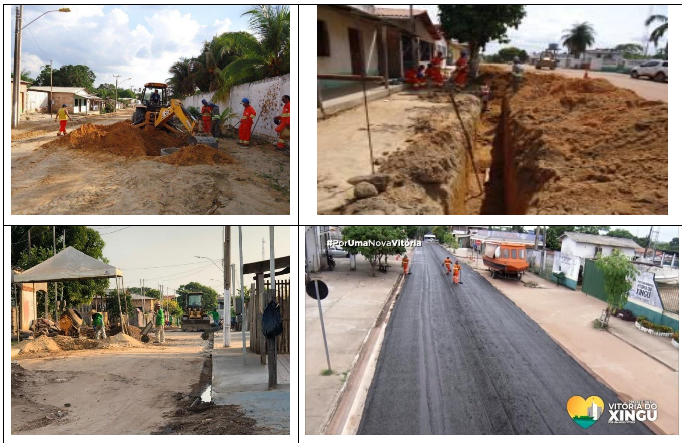
Figura 10. Instalação da rede de esgoto/ Abertura de vala e instalação da rede de esgoto Fonte: Prefeitura de Vitória do Xingu
