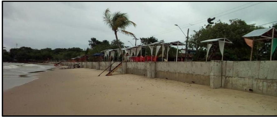
Figura 3: Muro de contenção da orla da praia da Marahu em Mosqueiro, janeiro de 2018. (Fonte: dynamistechne.com)
