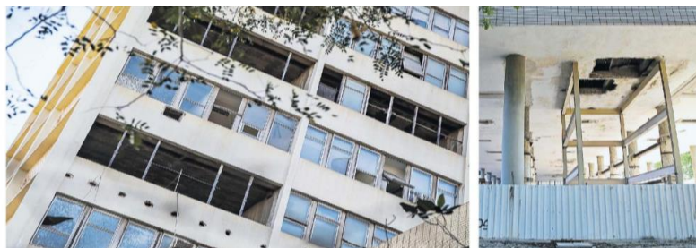
Figura 20 Perigo e negligência no Hospital Clementino Fraga Filho, no Fundão
