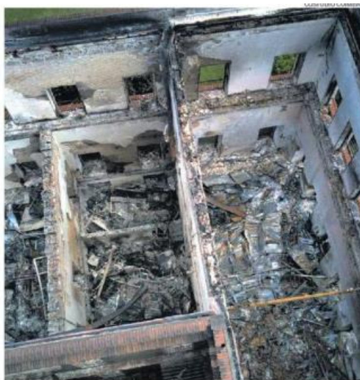
Figura 23 Cinzas: O Museu Nacional visto do alto após o incêndio: rumo à reconstrução
