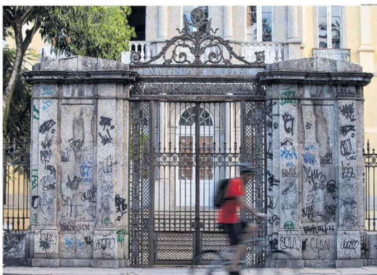
Figura 22 Abandono. Um dos prédios da UFRJ, no Campus da Praia Vermelha: Universidade é a gestora do Museu Nacional, que vinha sendo sucateado nos últimos anos devido à falta de investimentos e foi destruído no último domingo por um incêndio
