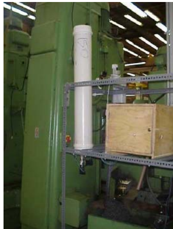
Figura 4.8: Tanque de armazenamento de óleo.
