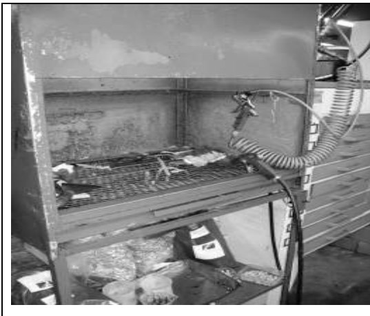
Figura 14: Cabine de limpeza antes da intervenção: cabine sem exaustores
