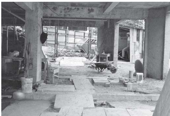
Figura 4.10 - Improvisação nas vias de circulação de equipamentos
