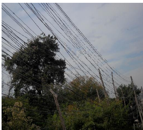
Figura 47: Fios de eletricidade puxados da Rua Prisma e que abasteciam as moradias da União Santa Tereza*
