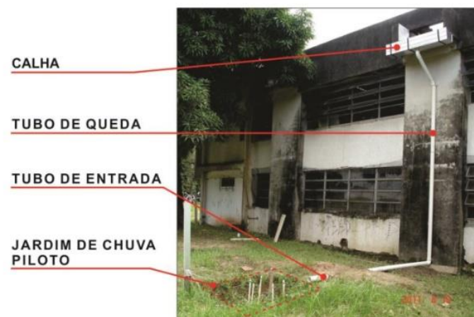
Figura 2 - Conjunto para captação das águas superficiais do telhado para o jardim de chuva piloto da UFPE.
