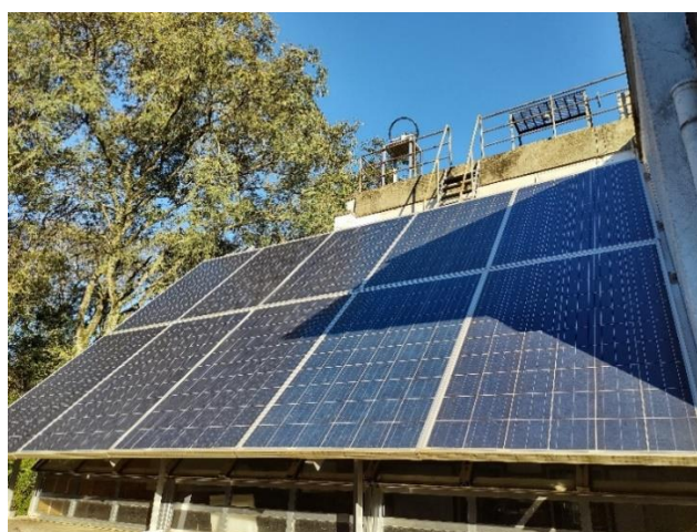
Figura 1: Sistema fotovoltaico instalado no Laboratório de Energia Solar em Porto Alegre (UFRGS).
