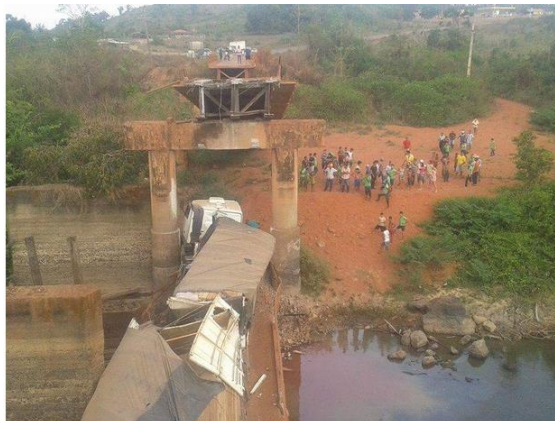
Figura 13. Colapso ponte sobre rio Arataú (Disponível em: http://g1.globo.com/pa/para/noticia/2015/12/ponte-sobre-o-rio-aratau-no-para-desaba-de-novo-um-ano-apos-reparo.html , acessado em 10/03/19 as 18:09).
