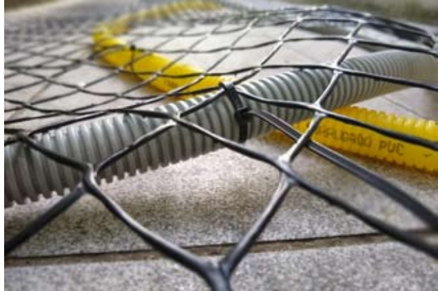
Figura 23: Eletrodutos de 2,5 centímetros de espessura, presos à tela por abraçadeiras de nylon pretas. Fonte: Stefanello Studio.
