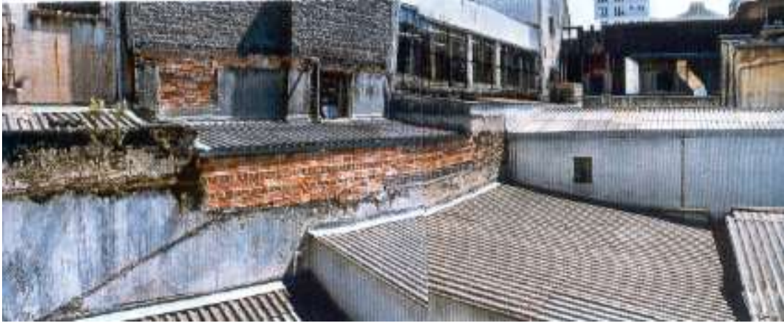
FIGURA 203 : Imagem de precariedade. Em caso de incêndio, o Corpo de Bombeiros não consegue chegar até o foco. Fonte : IPPUC.
