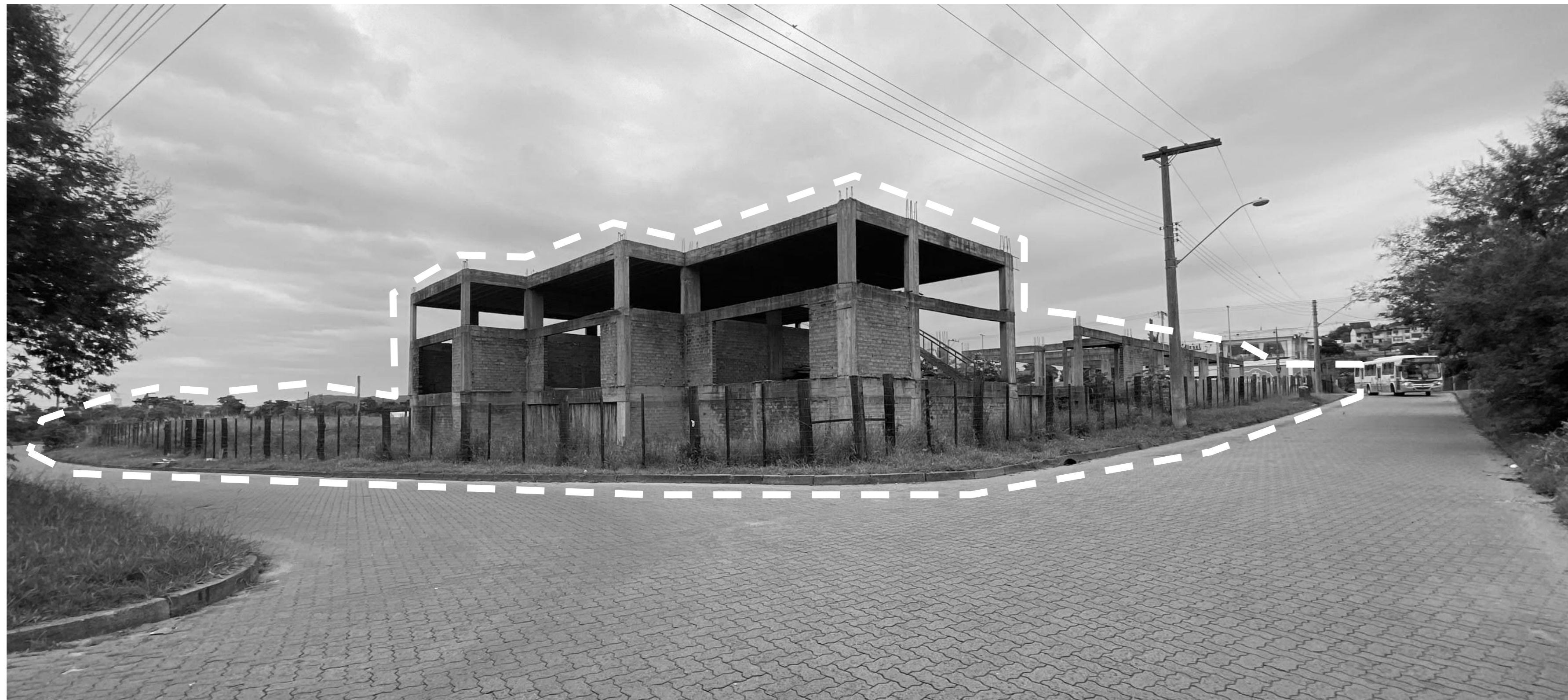
Vista G - Edificação a demolir na esquina Olívio K. e João B.
