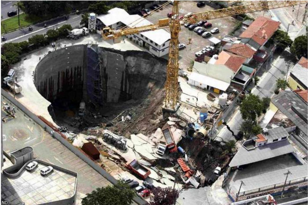
Figura 4.9 - Acidente na estação Pinheiros do Metrô de São Paulo (HANANE, 2018)
