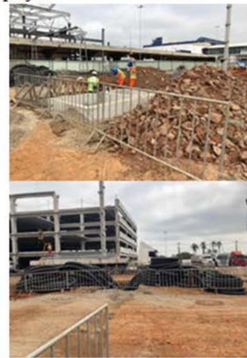
(c) detalhe - frentes de trabalho simultâneas não planejadas
