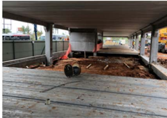
(a) trabalho inacabado devido a indefinição de projeto
