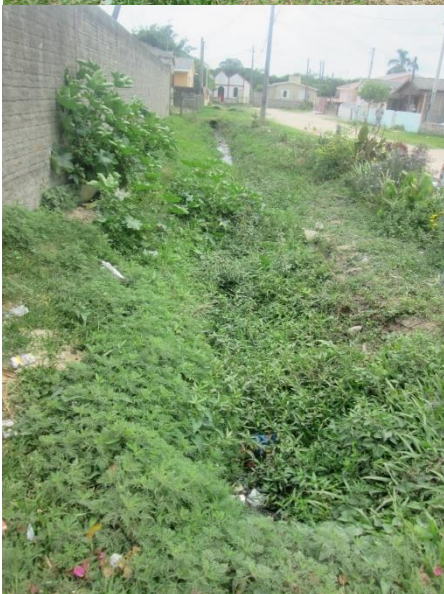
Figura 12 – valeta aberta na z3, Rua Nossa Senhora de Lourdes. Fonte: da autora
