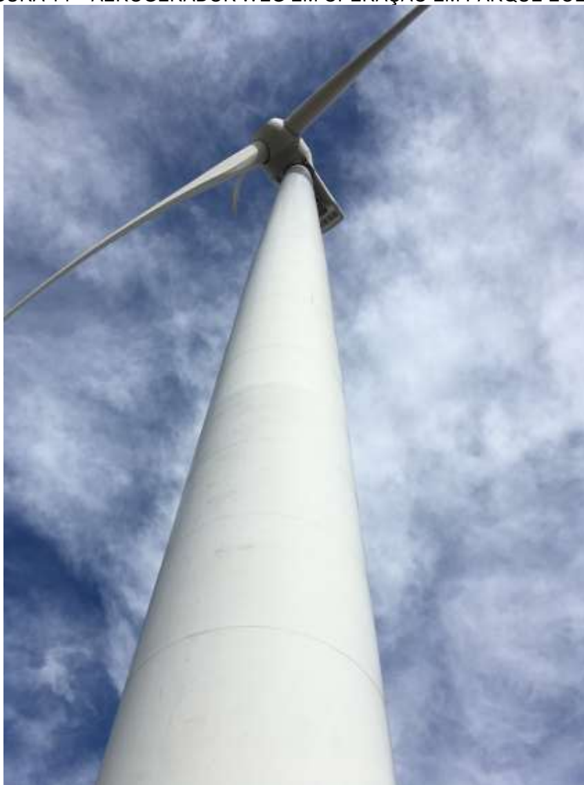
FIGURA 14 – AEROGERADOR WEG EM OPERAÇÃO EM PARQUE EÓLICO
