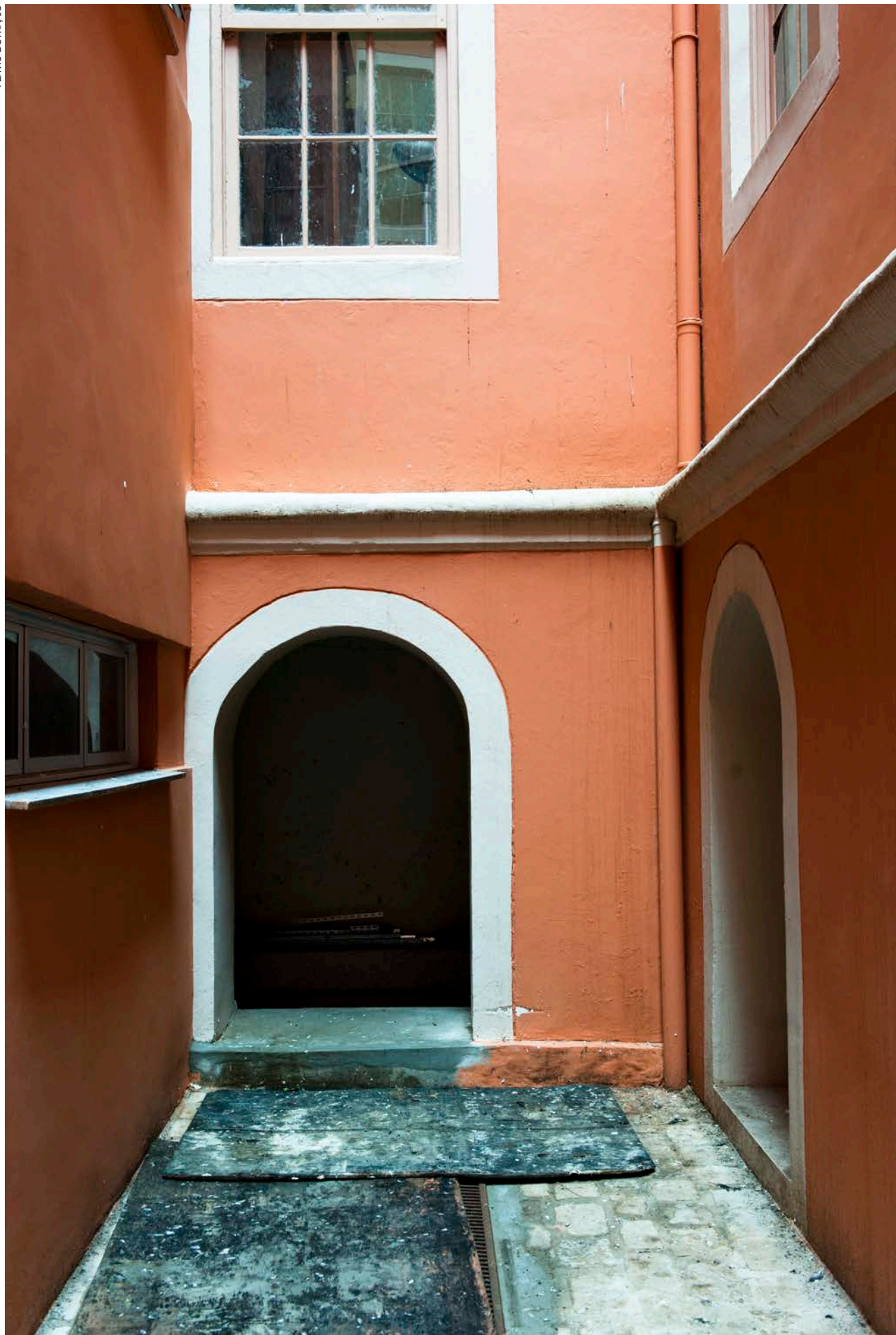
Detalhe do prédio da Escola de Engenharia, situado em frente à Praça Argentina, que está sendo restaurado
