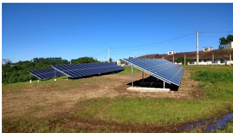
Figura A.14 – Visão geral do SFCR após concluída a fixação dos módulos.
