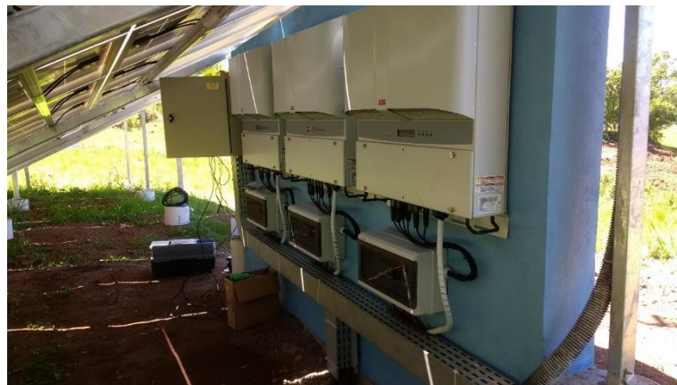
Figura A.16 – Detalhe da central de inversores em processo de montagem.
