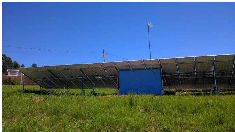
Figura A.18 – Detalhe da antena de comunicação fixada à central de inversores.
