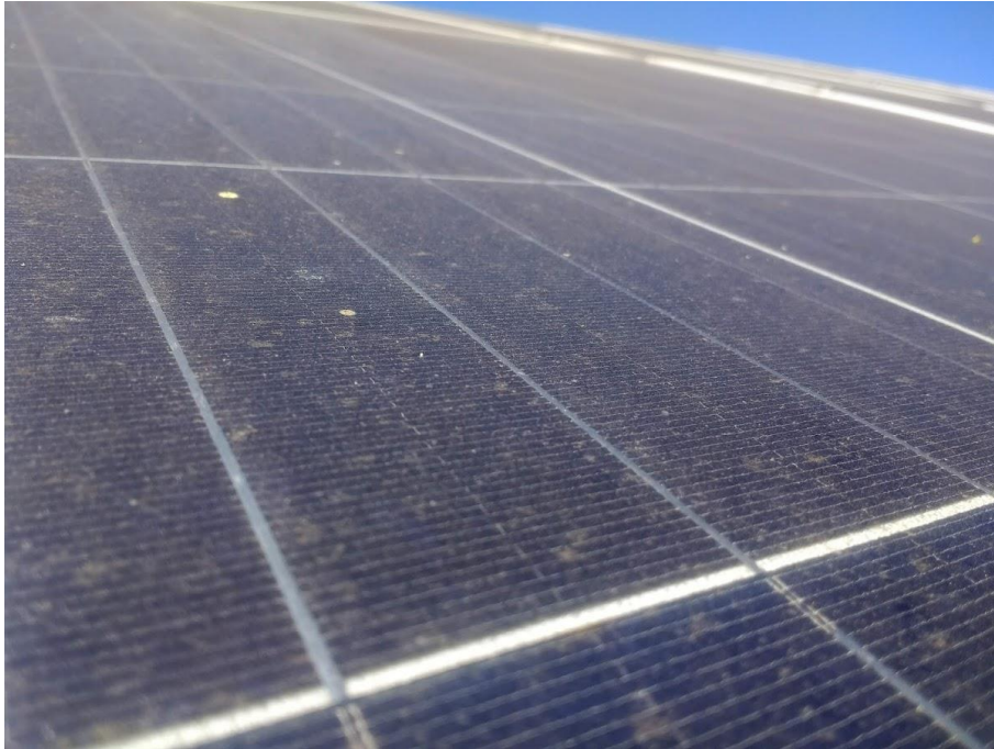
Figura 6.13 – Sombreamento causado por sujidade.
