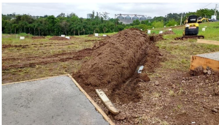
Figura A.8 – Abertura de canaletas no solo para posterior alocação de eletrodutos.
