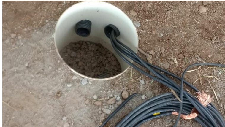
Figura A.17 – Detalhe de uma caixa de passagem aberta, com cabeamento exposto.
