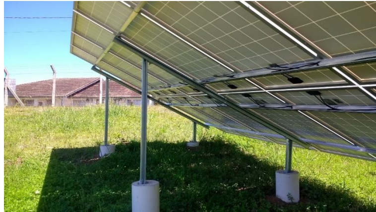
Figura A.15 – Detalhe da passagem de cabos de CC pelas canaletas das estruturas.
