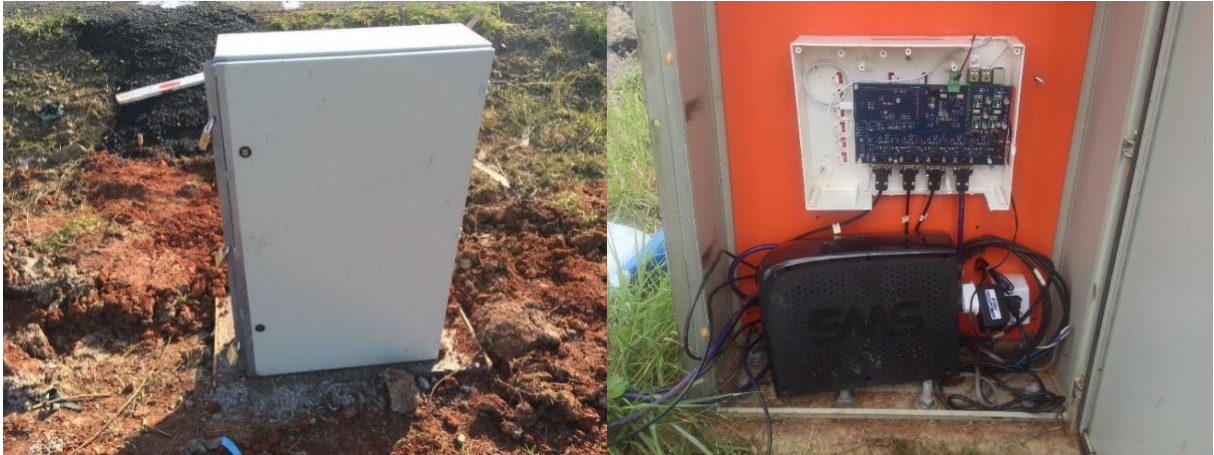
Figura 31 – Caixa de proteção com o sistema de aquisição de dados instalado.
