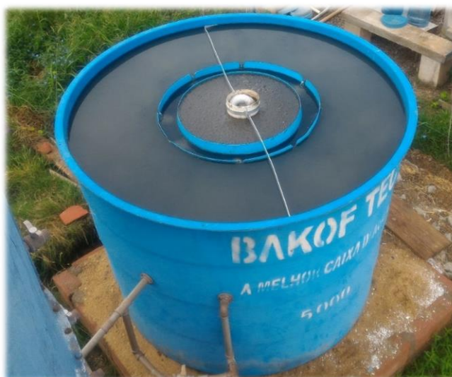
Figura 12 - Decantador para remoção de sólidos do efluente do UASB na ETE São João, Porto Alegre, RS.
