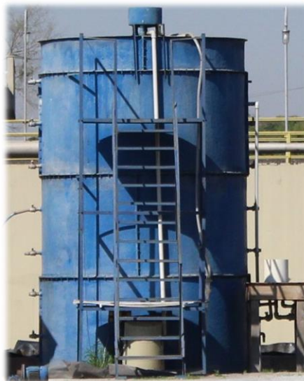
Figura 11 - Reator UASB em escala Piloto na ETE São João, Porto Alegre, RS.
