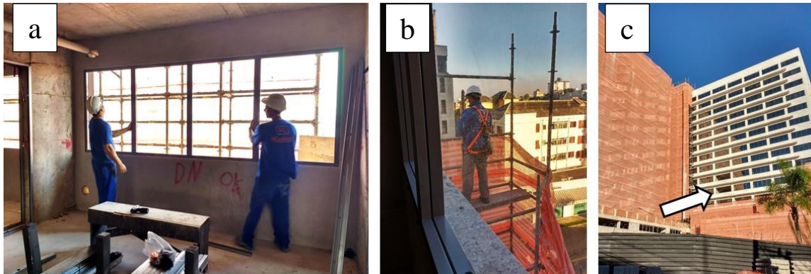
Figura 36 - Dependência entre (a) a instalação das esquadrias e (b) desmontagem do andaime fachadeiro, em que é deixado um (c) vão para passagem das peças do SPCQA
