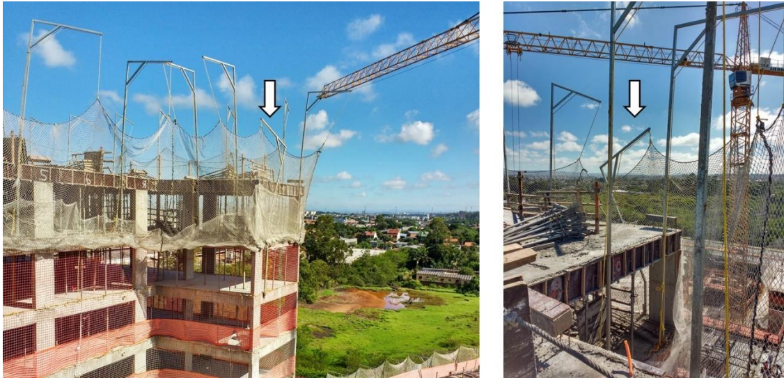
Figura 42 - Grua atingida pela força na obra A
