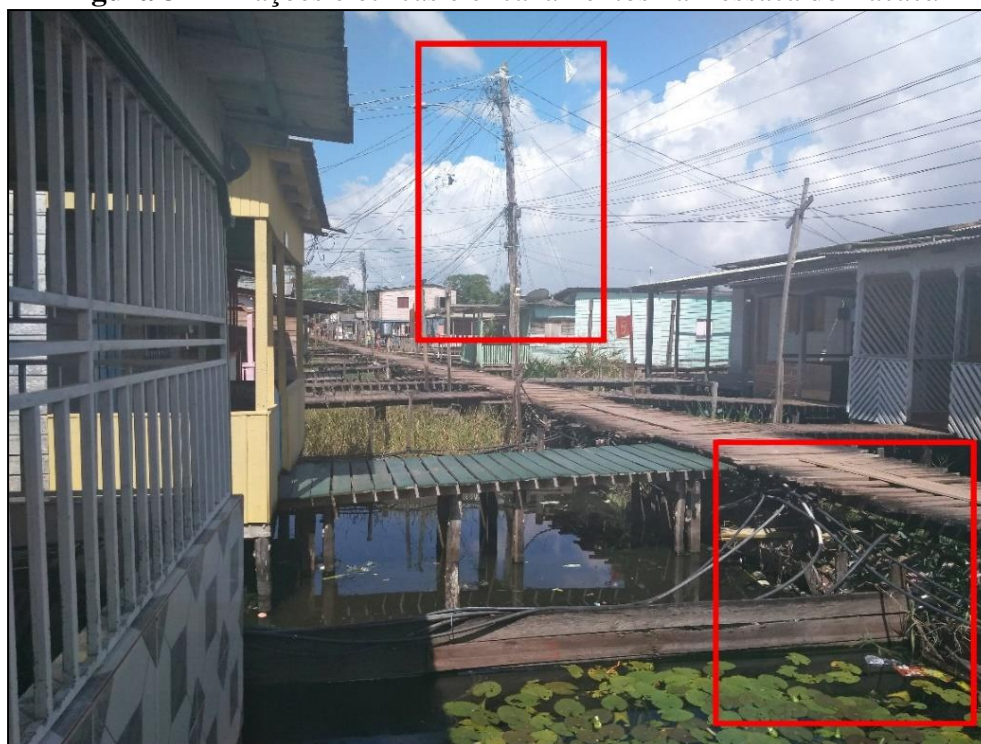
Figura 37 – Fiações elétricas e encanamentos na Ressaca do Tacacá
